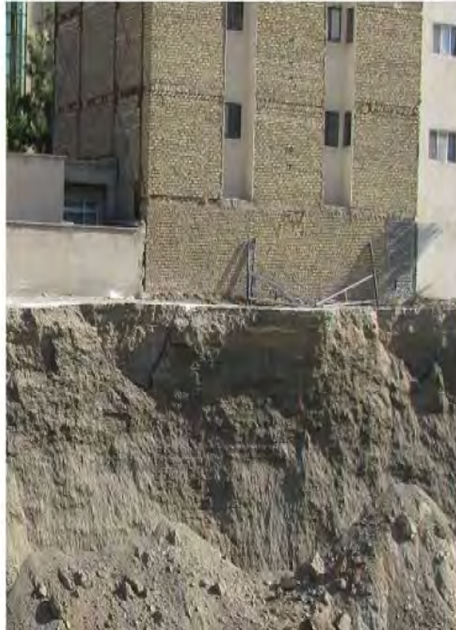
(الف) ترک پیش‌رونده در مجاورت پی ساختمان مجاور
