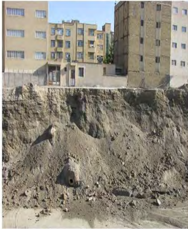
(ب) ریزش دیواره و ایجاد ترک در ساختمان
