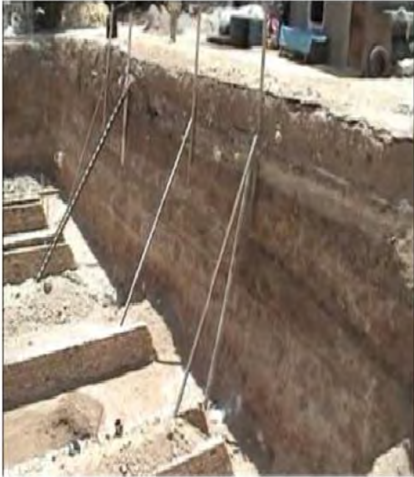
(ب) گودبرداری و سازه نگهدارنده غیر اصولی
