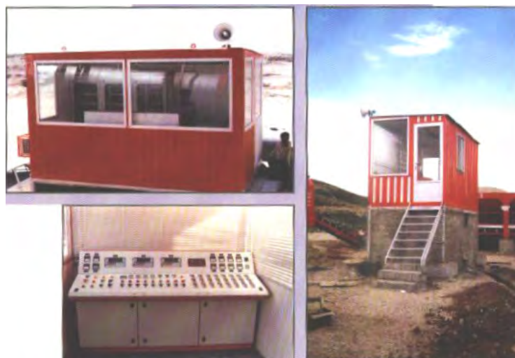
شکل شماره ۲-۲۱-۱۴- اتاق فرمان
