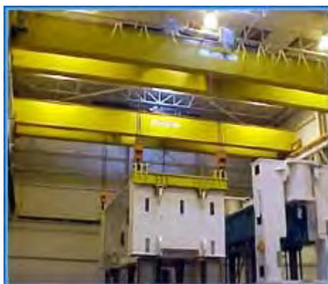
شکل ۶-۵-۵- جرثقیل دروازه‌ای دو پل
