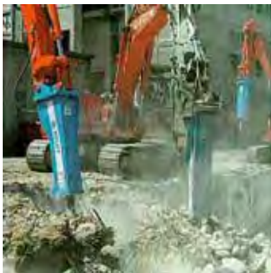
شکل ۳-۱۰-۳- تخریب ساختمانهای قدیمی
