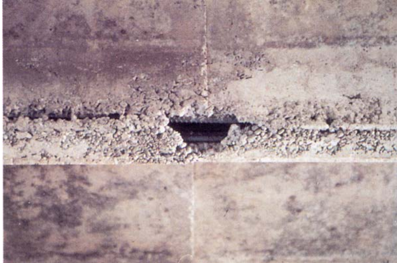
شکل ۸ نمونه‌ای از نحوه نامناسب تراکم بتن
