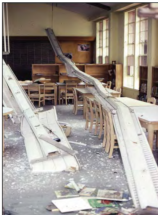
شکل ۱۰-۲- آسیب به سیستم روشنایی در هنگام زلزله
