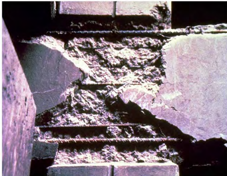
شکل ۲-۶-۸ کمانش میلگردهای طولی تیر در ناحیه اتصال
