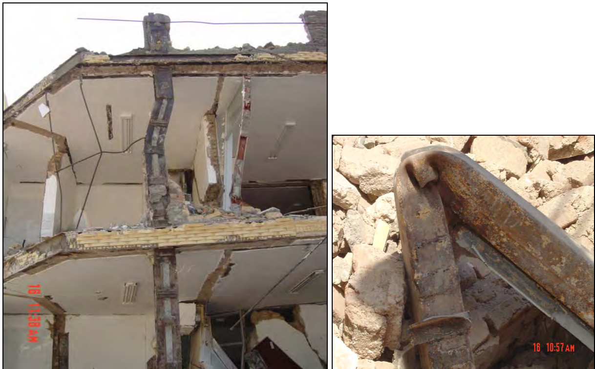
شکل ۲-۵-۱۹- نمونه‌ای از خرابی ستون‌های فولادی
