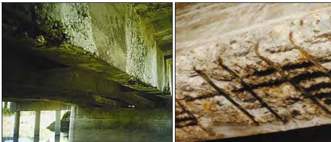
شکل ۲-۴-۱- نمونه‌هایی از آسیب‌دیدگی تیرهای بتنی
