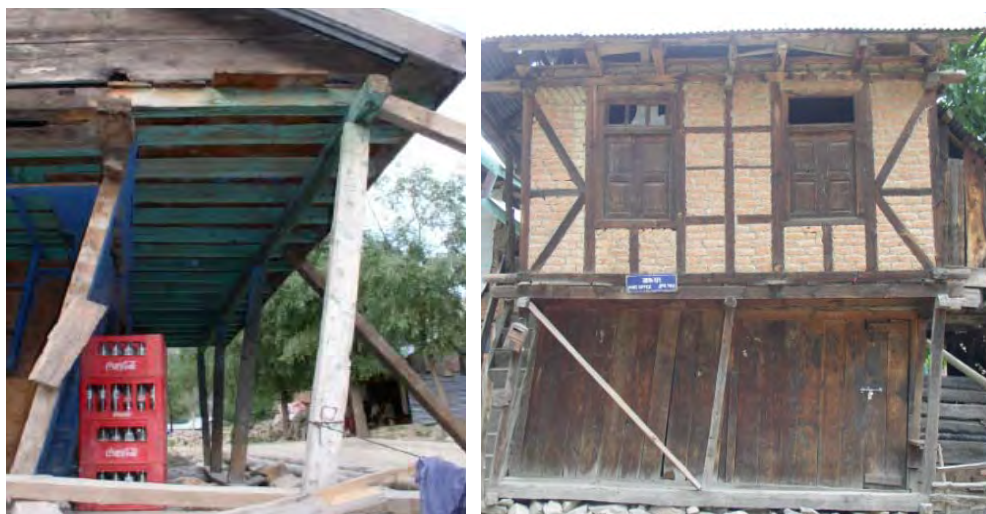
شکل ۹-۳۶ تغییرشکل جانبی دائم سازه به علت عدم وجود بادبندهای مناسب و یا اتصالات ضعیف بادبندها
