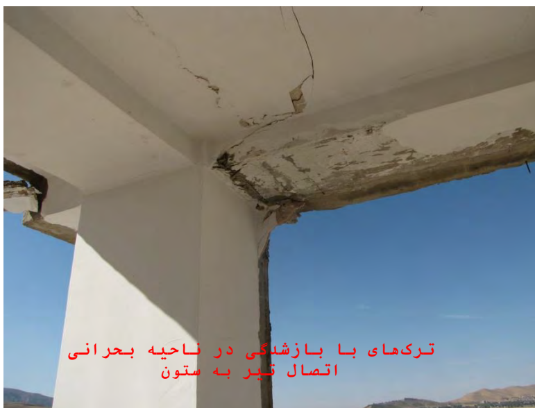
تغییر شکل یکی دیگر از ستون‌های طبقه دوم
