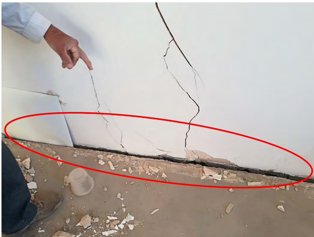
شکل (۶-۷): جدایش‌دگی کف از سیستم باربر جانبی در یک ساختمان مصالح بنایی
