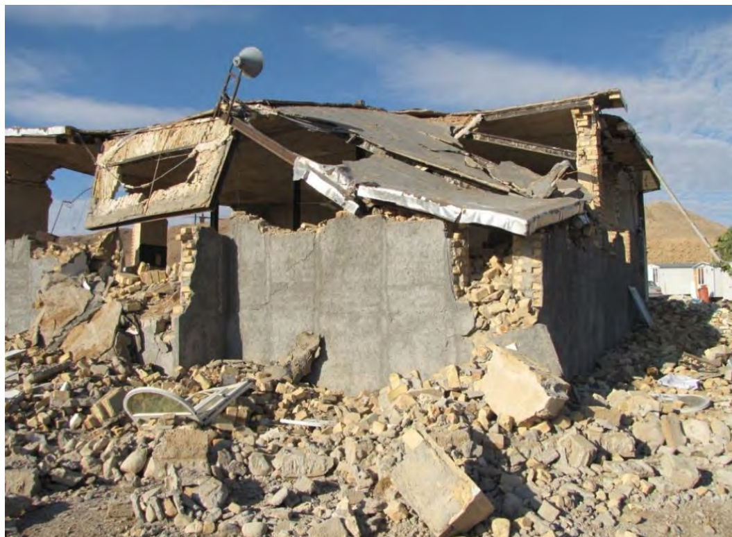
شکل (۶-۲): فروریزش در ساختمان مصالح بنایی بدون کلاف
