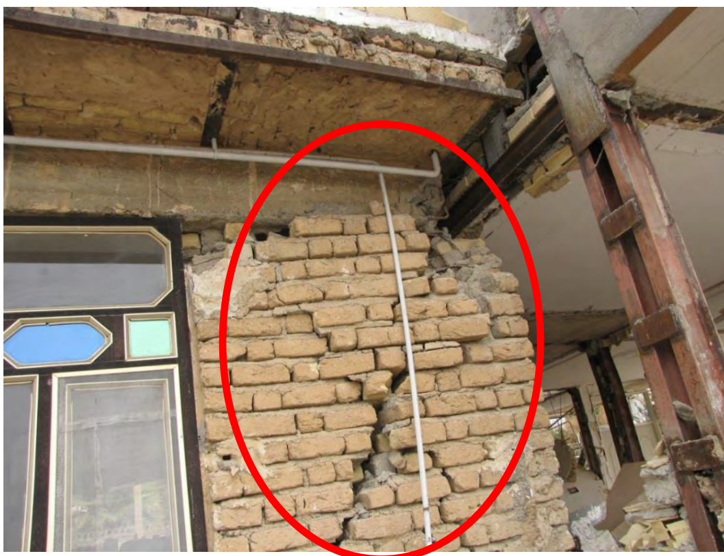
شکل (۶-۸): خرابی در سیستم باربر قائم در یک ساختمان مصالح بنایی بدون کلاف
