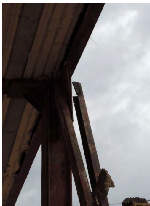
شکل (۴-۱۴): آسیب در جوش مهاربند
