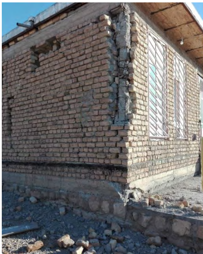
شکل (۶-۲۵): وجود ترک‌های عریض در دیوار یک ساختمان مصالح بنایی کلاف‌دار
