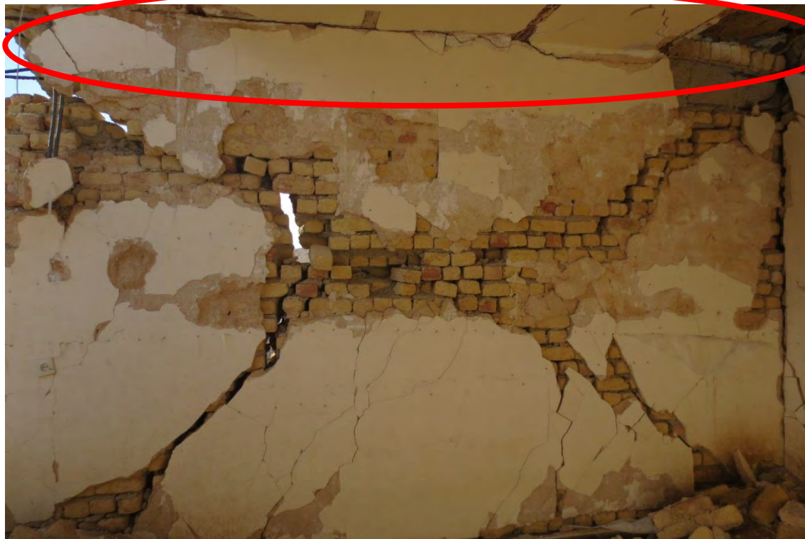
شکل (۶-۱۱): جابجایی یا شکستگی در اتصال برشی بین دیافراگم و دیوارهای باربر یک ساختمان مصالح بنایی
