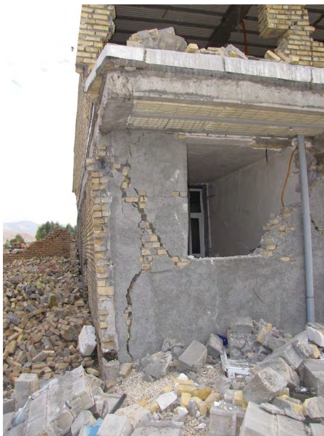
شکل (۶-۲۰): فروریزش موضعی در یک ساختمان مصالح بنایی کلاف‌دار
