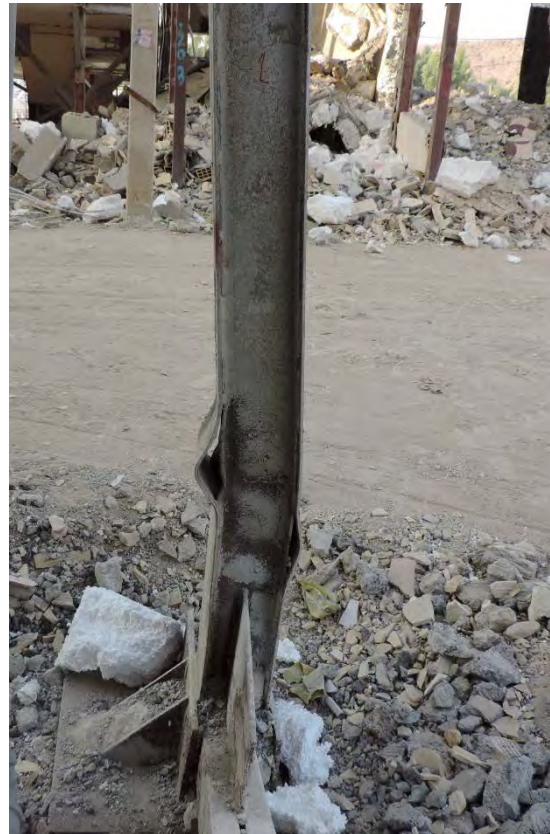
شکل (۴-۷): کمانش کلی ستون، کمانش موضعی، تشکیل مفصل پلاستیک
