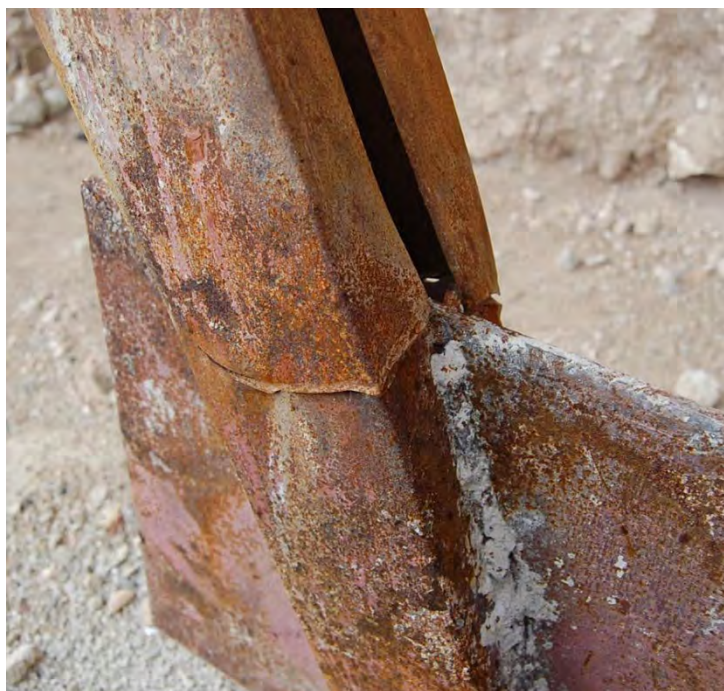
شکل (۴-۱۵): گسیختگی مهاربند (شکست کششی)
