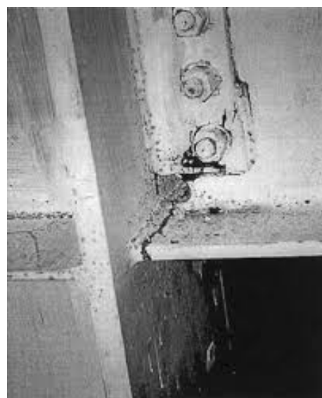
شکل (۴-۲۹): آسیب در اتصال پیچی
