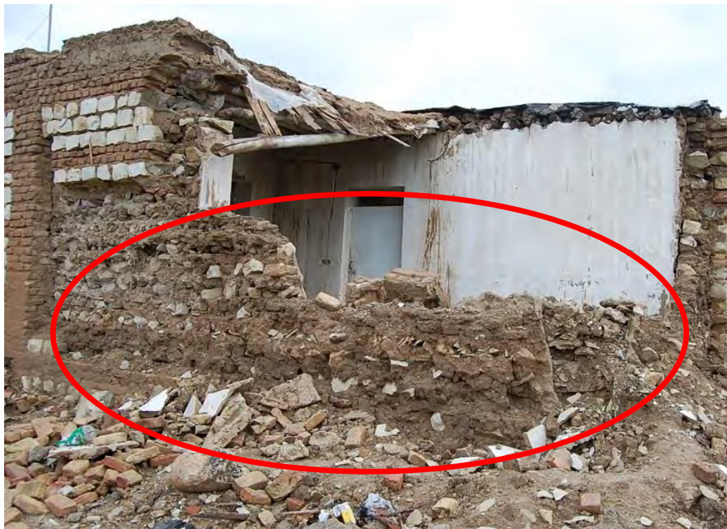
شکل (۶-۱۷): وجود دیوار باربر ساخته شده از خشت و گل که در زلزله آسیب دیده است
