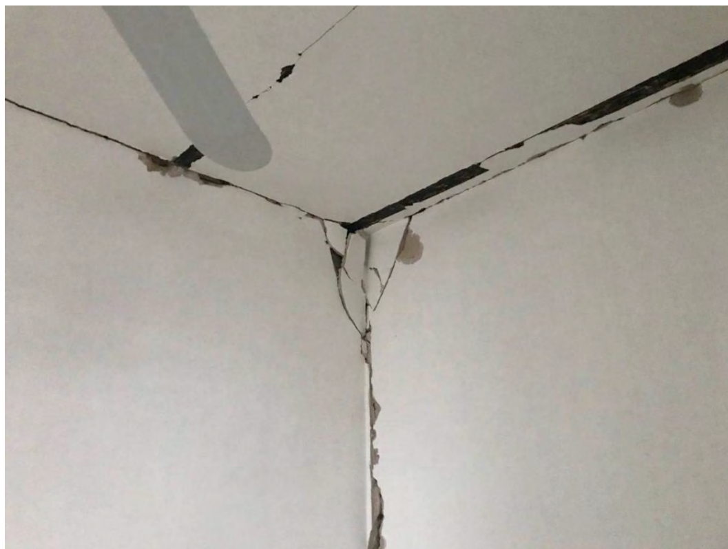
شکل (۶-۶): جداشدگی سقف از سیستم باربر جانبی در ساختمان مصالح بنایی
