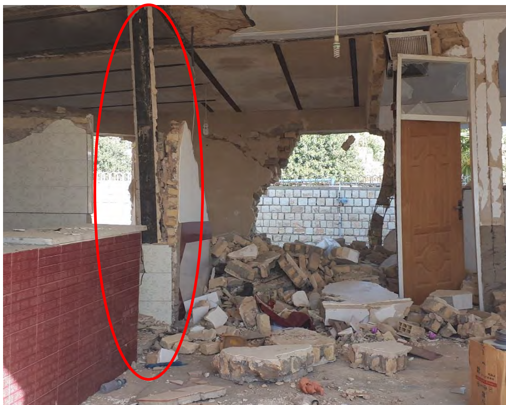
شکل (۶-۲۹): کماتش ستون‌ها در یک ساختمان مصالح بنایی بدون کلاف
